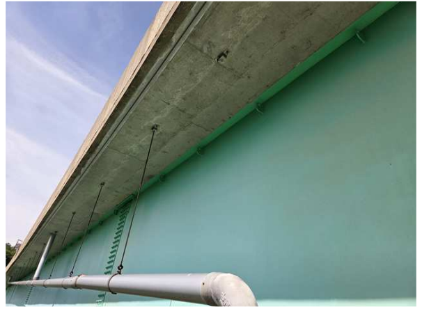
배수관 행거로이드 탈락
